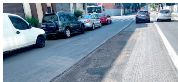
Desníveis foram ocasionados após serviços feitos pela Sabesp
