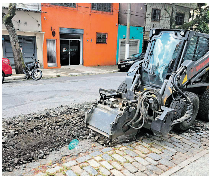
Buraco na Rua do Fico tem incomodado os moradores
